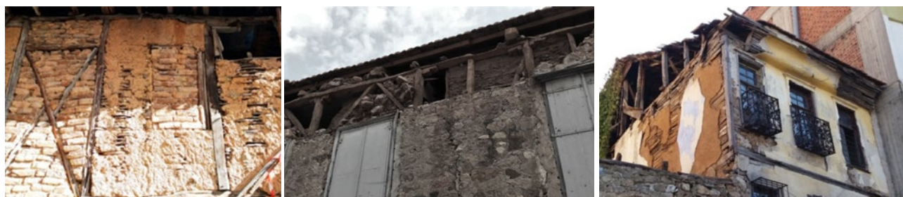
Fig. 4. Esempi di tecniche costruttive greche che impiegano terra e legno – © 2020, A. Mousourakis.
