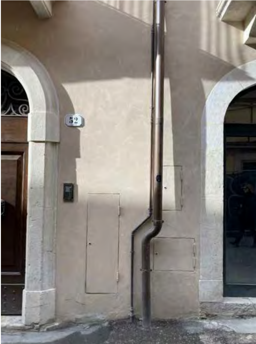
Figura 5. L'Aquila. La consuetudine di collocare su strada i contatori delle utenze (comunemente imposta dai gestori delle forniture) provoca diffusi scassi nelle murature, eseguiti sulle porzioni resistenti senza alcuna cognizione delle criticità strutturali. Il problema è particolarmente evidente nei centri storici, in corrispondenza delle unità abitative appena ristrutturate (foto C. Bartolomucci, 2023).
