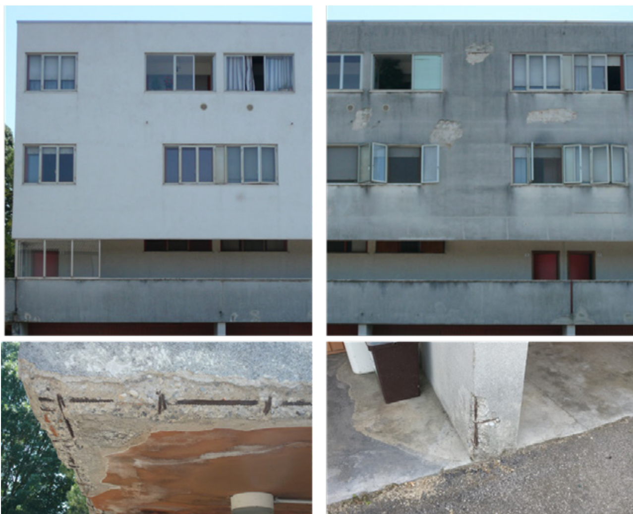
Fig. 4. In alto la facciata nord del blocco est: a sinistra la piccola parte in cui è stato installato il rivestimento isolante esterno. A destra il rivestimento originale con distacchi di intonaco. In basso dettagli dei distacchi di copriferro nelle travi dei ballatoi e nei diaframmi in calcestruzzo. © 2019, Prati.
