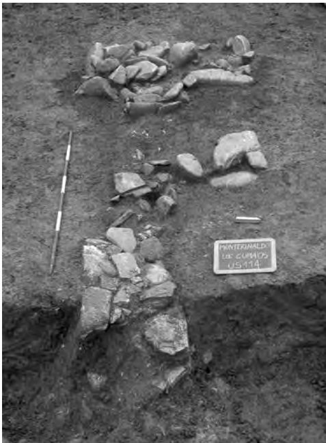
Fig. 55. Particolare delle fondazioni di uno dei setti divisori del portico orientale con l'antistante fondazione di una delle basi del portico (A.SABAP-M.).
