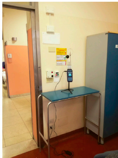
Figure 8. Picture of datalogger position in control room n.15.
