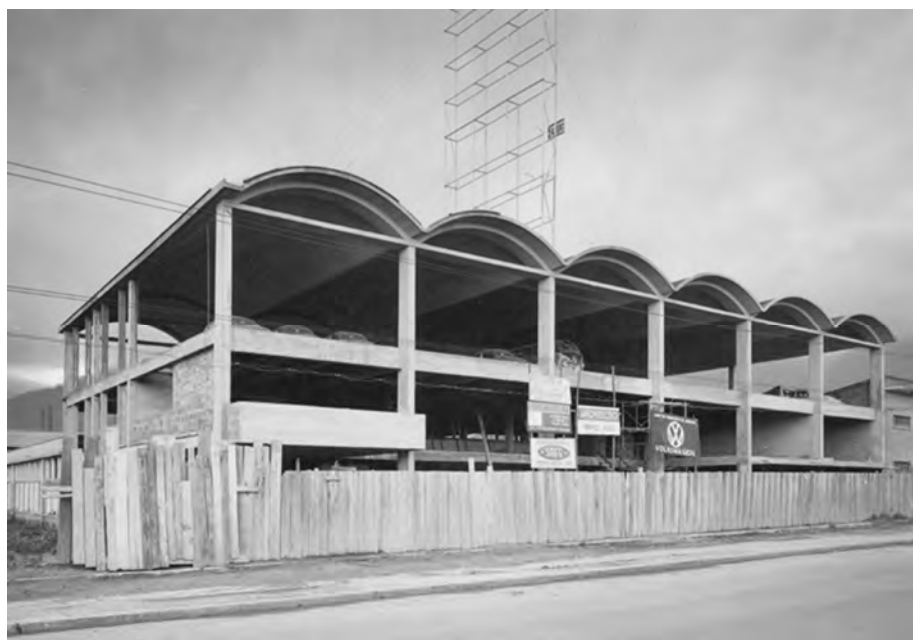
Figura 70. Volkswagen, foto dell'edificio in costruzione, senza data. Fonte: Universidad Nacional de Colombia, Bogotá D.C., Facultad de Artes, Museo de Arquitectura Leopoldo Rother, Collezione Bruno Violi.
