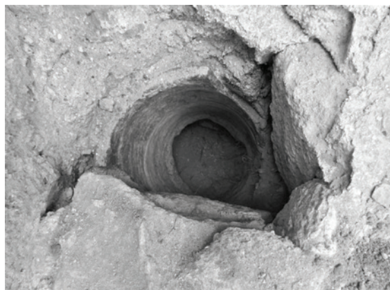
Fig. II.2.21. Basilica Nord, narcece. Canaletta fittile (USM 167) inserita nell'USM 91 (foto di V. Casali).
