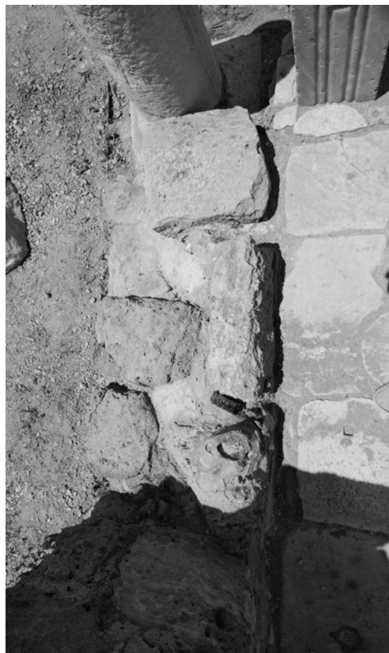
Fig. II.2.17. Basilica Nord, presbiterio. Setto murario (USM 44) a chiusura del tratto orientale nello stilobate S (foto di V. Casali).
