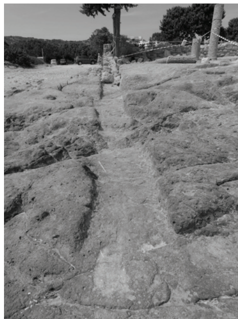
Fig. II.1.2. Atrio triportico (vano VI). Lo scavo del banco di roccia (US -199, -200) per l'alloggiamento dei muri perimetrali (angolo tra USM 8 e 13; foto di G. Marsili).
