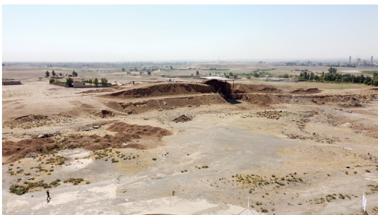
Fig. 7. Lo stato delle mura nord distrutte da ISIS/Daesh ancora nel 2021, nei pressi della Porta di Adad già sgombrata dalle macerie e protetta da una nuova tettoia.
